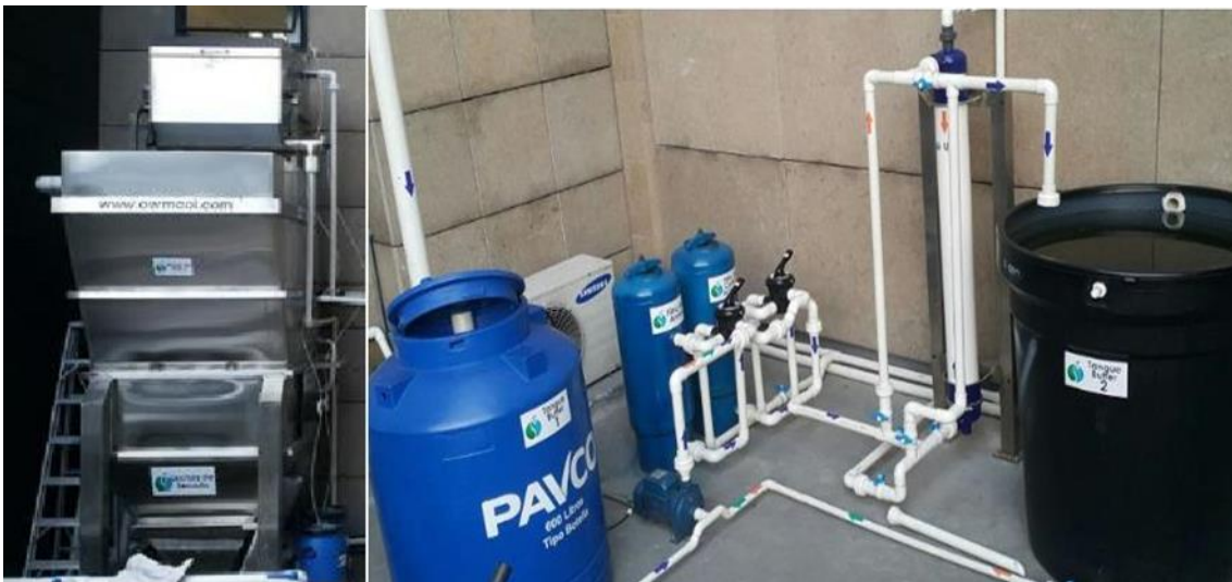
PTAR SISTEMA TSOC DE 1.6 LPS
