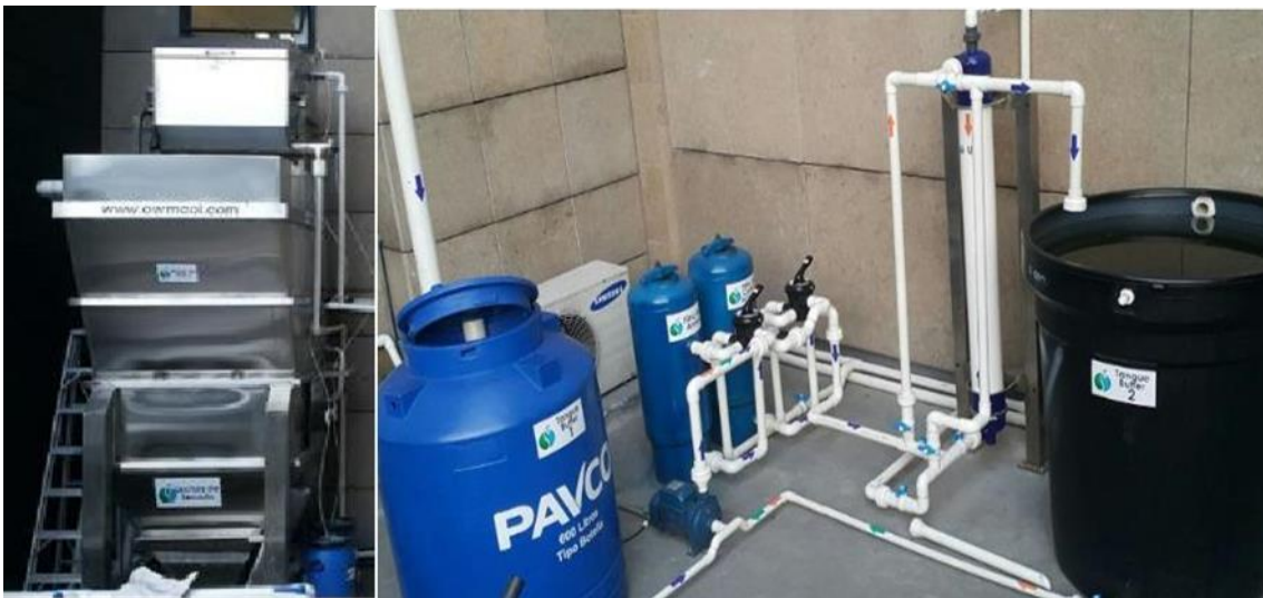
PTAR SISTEMA TSOC DE 1.6 LPS
